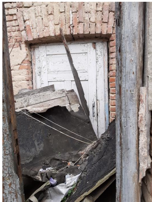
Widok drzwi i zapadniętego dachu
